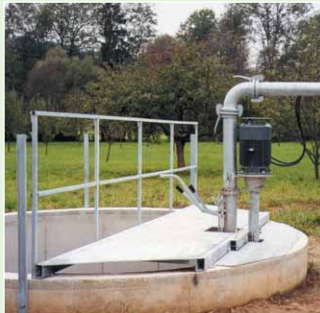
LE-Pumpe zum Umpumpen, fix installiert
